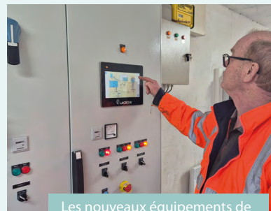
Les nouveaux équipements de la station de pompage
